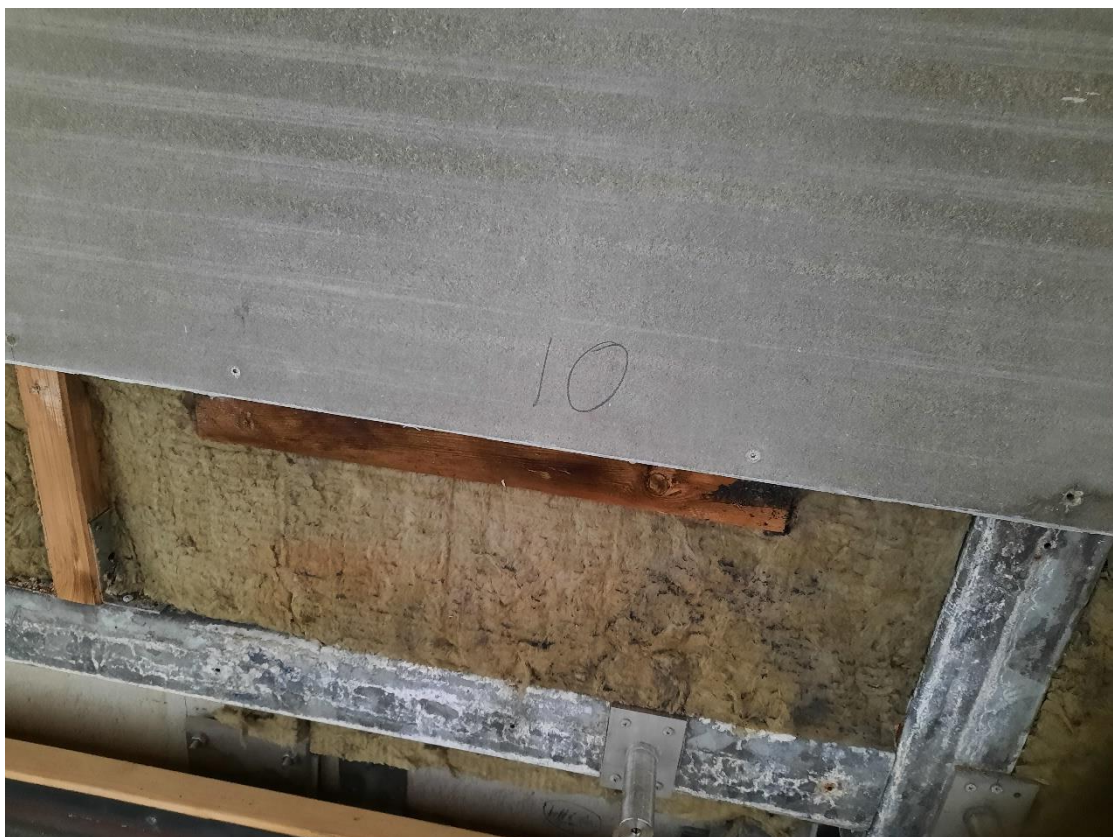
Rot í timbri og soppur í isolering
