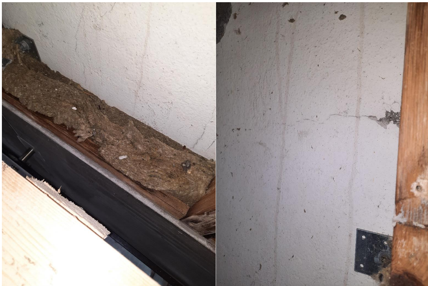
Rivur í betongveggi og væta í timbri
