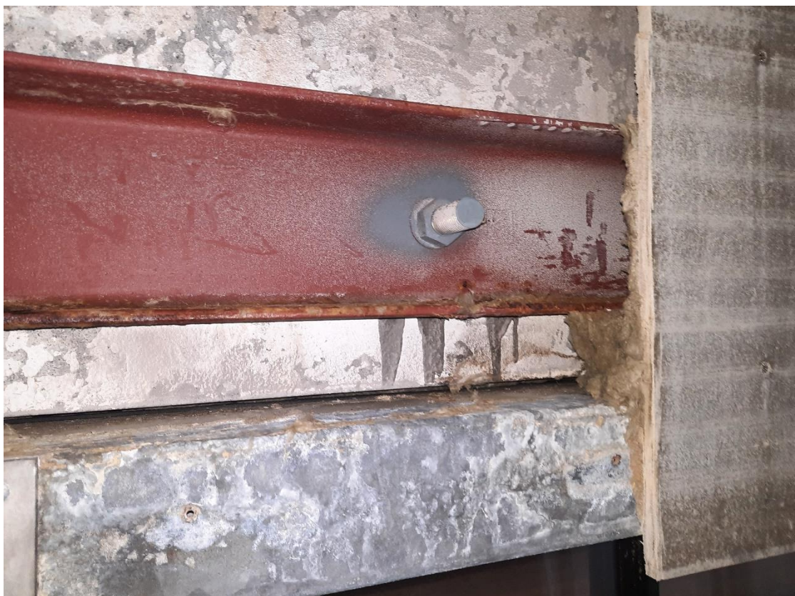
Svart stálfesti yvir vindeyga. Tæring í stáli.
