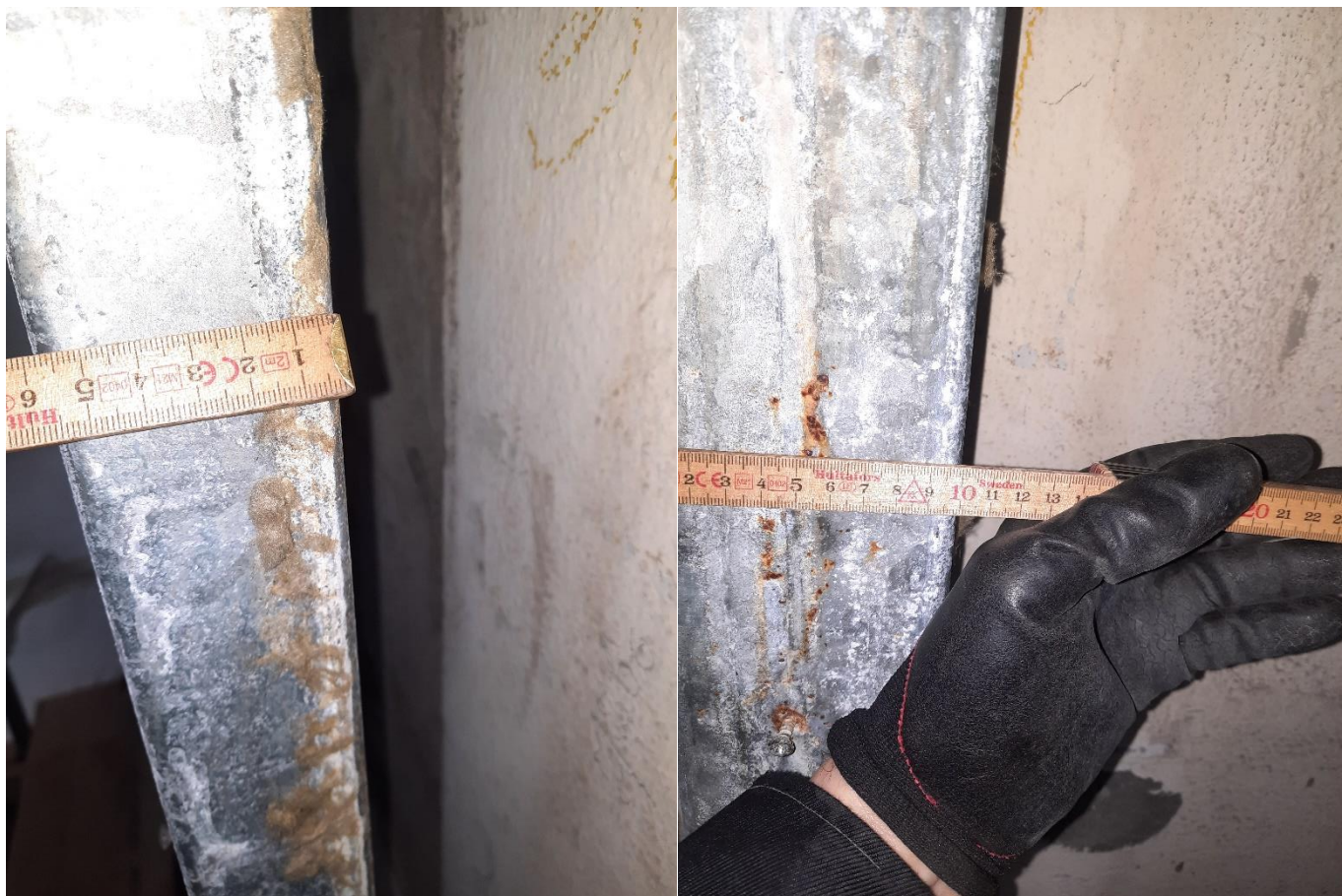
Stødd á RHS profíli. Tæring í stáli
