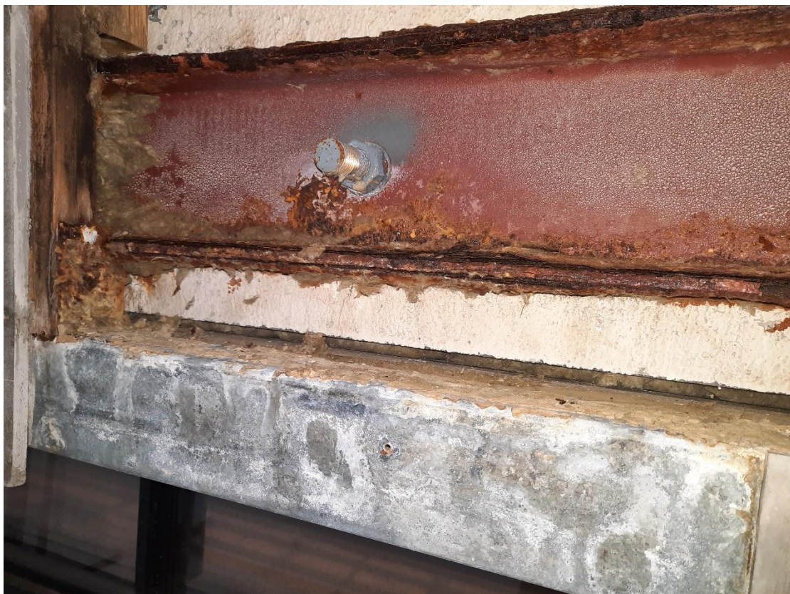
Svart stálfesti yvir vindeyga. Tæring í stáli
